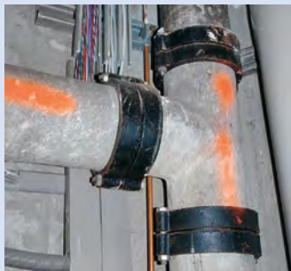
Tuyaux en fibrociment
