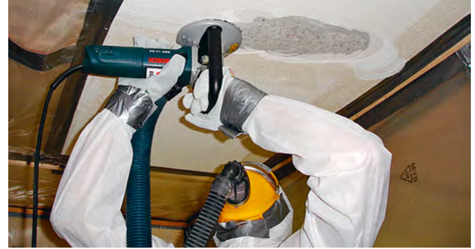
Enlèvement uniquement par des entreprises en désamiantage reconnues
