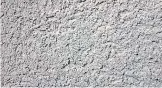
Crépi acoustique amianté
