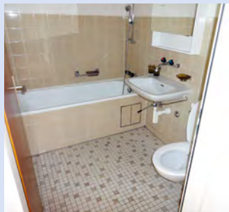
Colle amiantée derrière le carrelage
