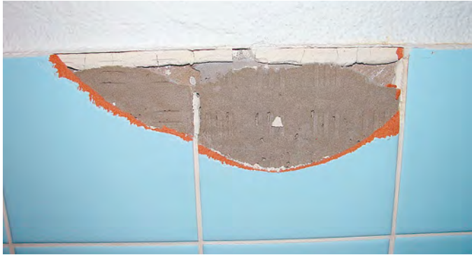
<1% Amiante chrysotile dans la colle
