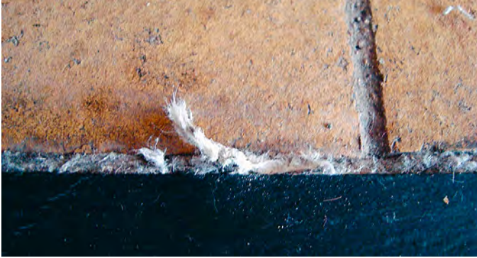
Cordon en amiante dans une cheminée
