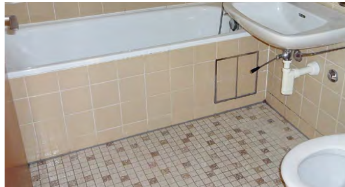
Carrelage avec colle amiantée
