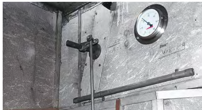
Canal d'aération avec plaques en fibrociment
